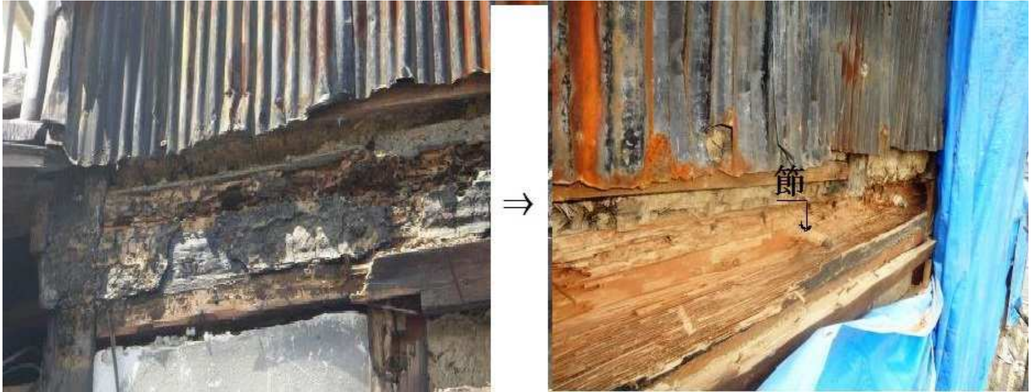
木造住宅梁腐食部
