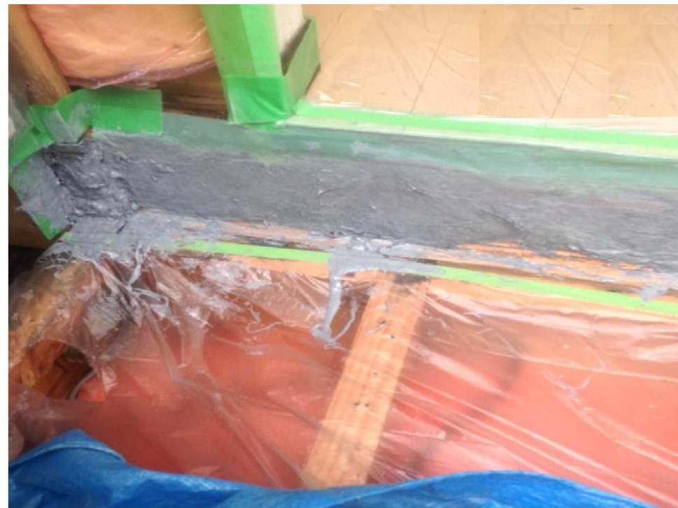
強化繊維とエポキシ樹脂に依る断面欠損復旧・補強過程
